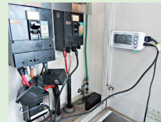
電力ロガーを使用し、各設備の計測を行っています。
